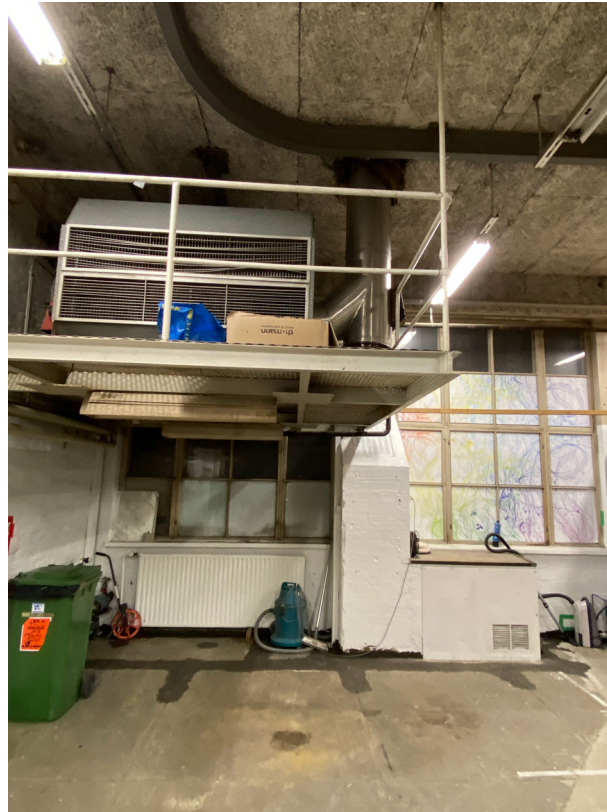
Kuva 32. Muun muassa halliosaan on sijoitettu ilmanvaihtokone.
